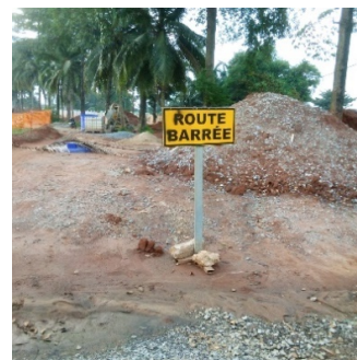
Photo 4. Signalisation montant RN 36 barrée par endroits
